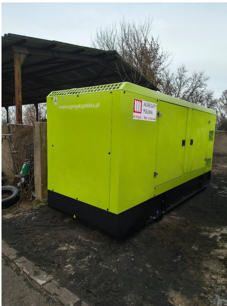
Zdjęcie Nr 6. Agregat stacyjny z możliwością transportu o mocy 200 kW
