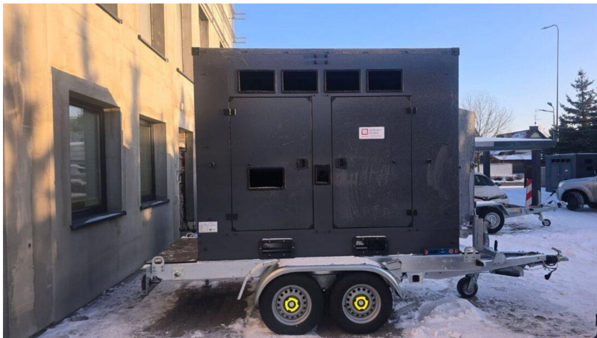
Zdjęcie Nr 7. Agregat mobilny o mocy 100 kW
