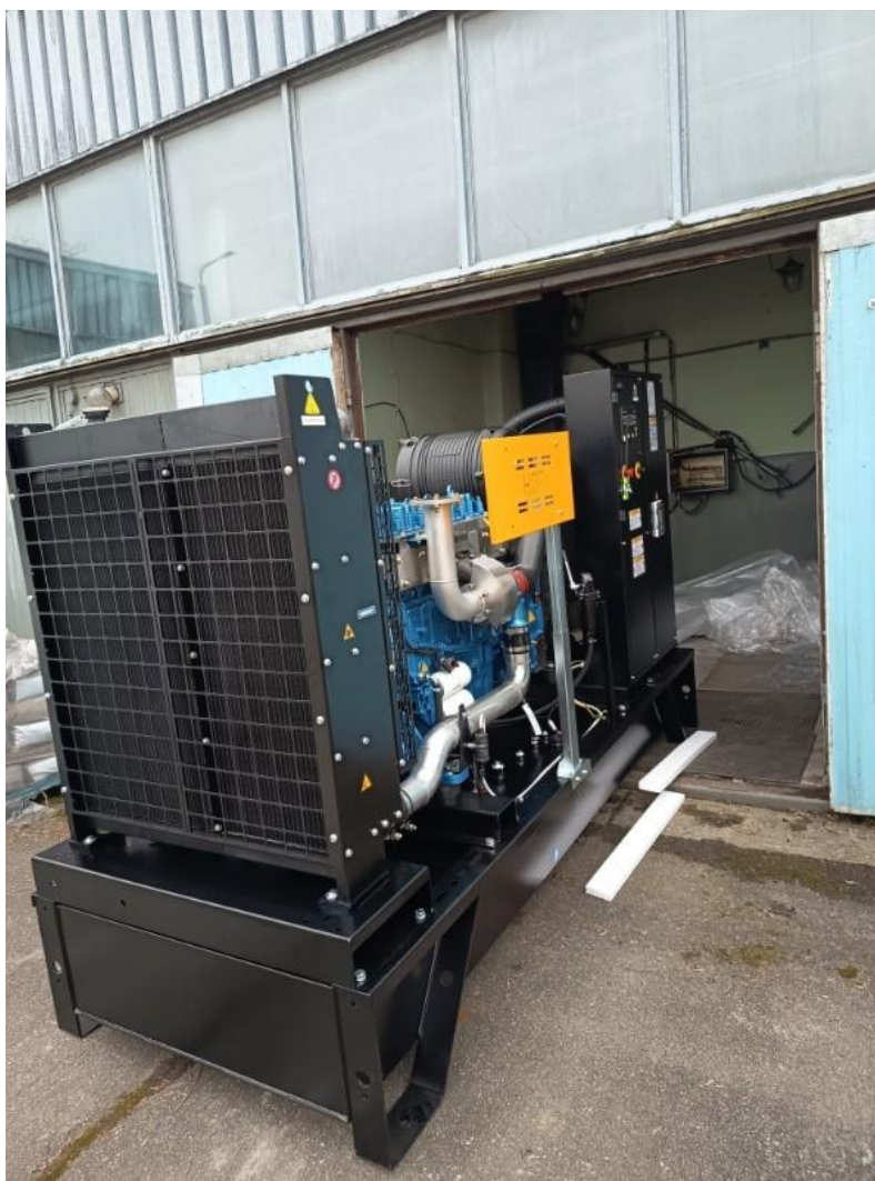
Zdjęcie Nr 5. Agregat stacyjny o mocy 200 kW Źródło: Opracowanie własne
